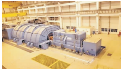
图14 华龙一号首台核能发电机在电站投入运行
